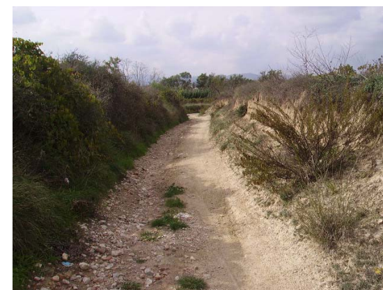
Tram 1: Estat del ferm
