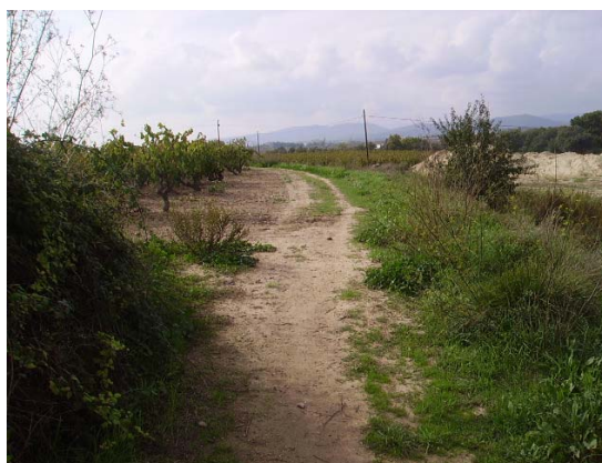
Tram 1: Estat del ferm
