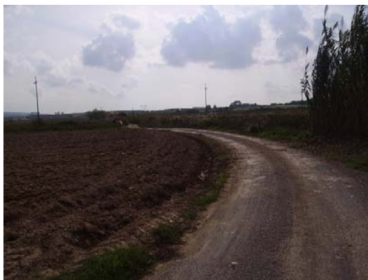
Tram 1: Estat del ferm
