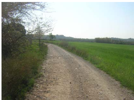
Tram 1: Estat del ferm
