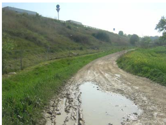
Tram 1: Estat del ferm
