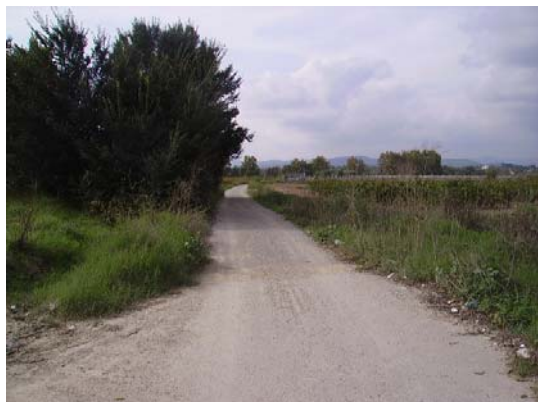
Tram 1: Estat del ferm
