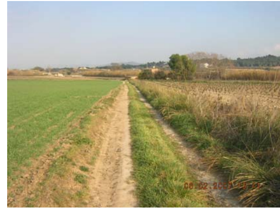
Tram 1: Estat del ferm
